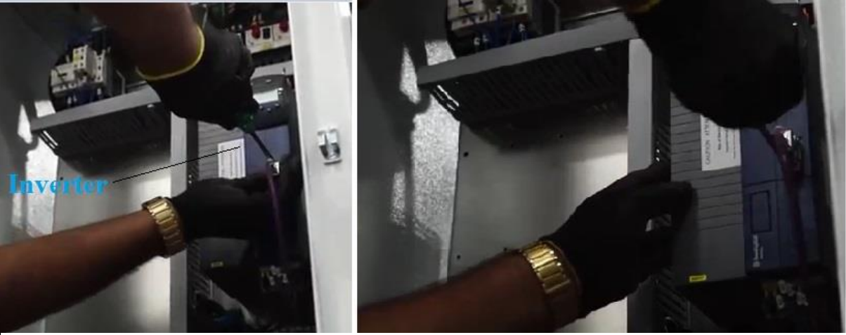
شكل رقم ١٠: فحص وصلات المحول الكهربائي (الانفرتر)
